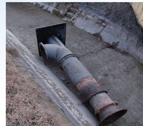
Pompa dell'impianto di Bastella
