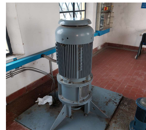
Motore dell'impianto di Bastella
