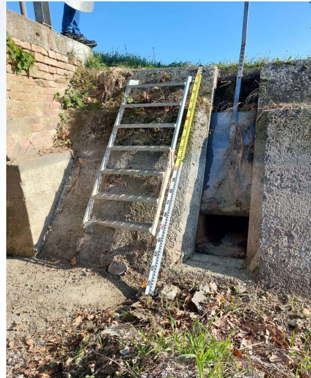
Paratoie di derivazione sul canale
